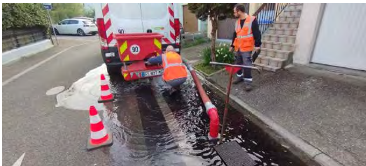
Test d'une bouche incendie
